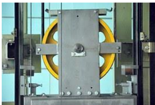
▲ Контроль навантаження на шківі
